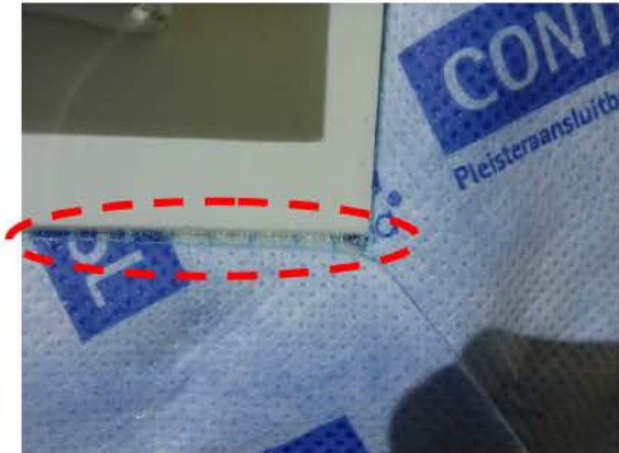
Kuva 14. Liitosnauhan liimapinta vaikutti irronneen paikallisesti alustastaan noin 1-2 mm leveydeltä. Tarkasteltaessa asennusta havainnon todettiin johtuvan kuitenkin liitosnauhan hieman vinoon toteutuneesta asennuksesta karmipintaan. Nauhan liimapinta ylitti karmin reunan paikallisesti.
