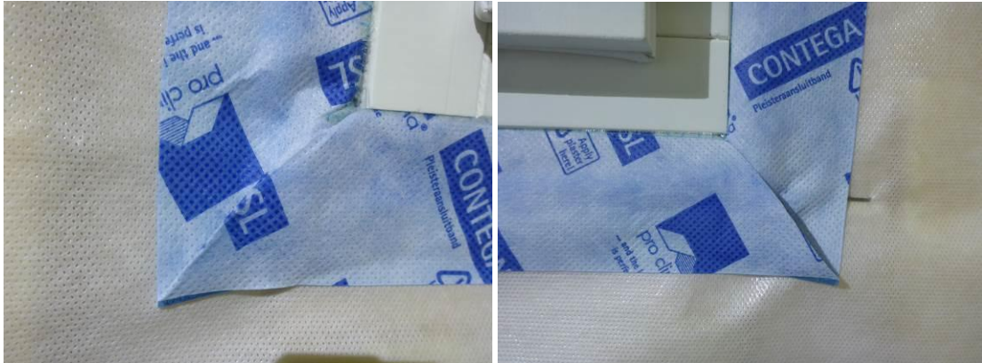
Kuvat 6 ja 7. Ikkunan alanurkkien nurkkaliitokset toteutettiin taittamalla nauhaa siten, että taitos mahdollisti liitosnauhan kääntymisen laskostettuna nurkan ympäri.
