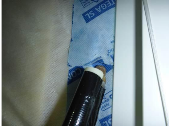
Kuva 18. Merkittävää vuotoa havaittiin liitosnauhan limityskohdassa, jossa leikatut nauhan päät oli yhdistetty.
