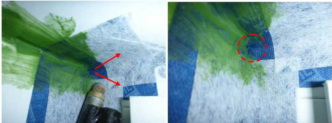
Kuvat 9 ja 10. Merkkiainelaitteella havaittiin ilmapuotoja kaikista nurkissa nurkkakappaleen takakulmista. Vuodot olivat voimakkuudeltaan vähäisiä.
